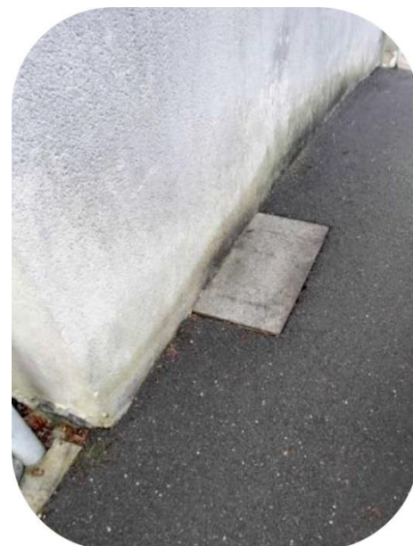
Arrivée EF de la maison par le sol (vue extérieure)
