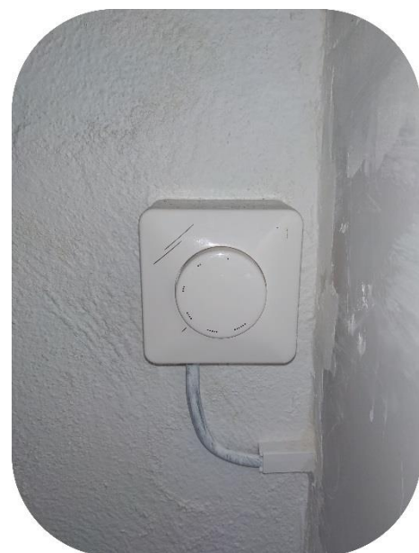
Potentiomètre de réglage de débit du ventilateur
