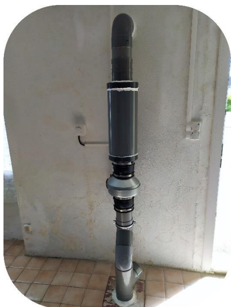
Installation du S.D.S avec silencieux en partie habitée
